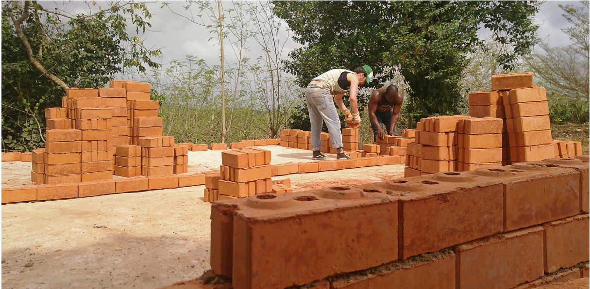
05 Internationaler Austausch während des gemeinsamen Baus eines einfachen Gebäudes aus Lateritsteinen auf dem Gelände der Agege Farm in Ghana
