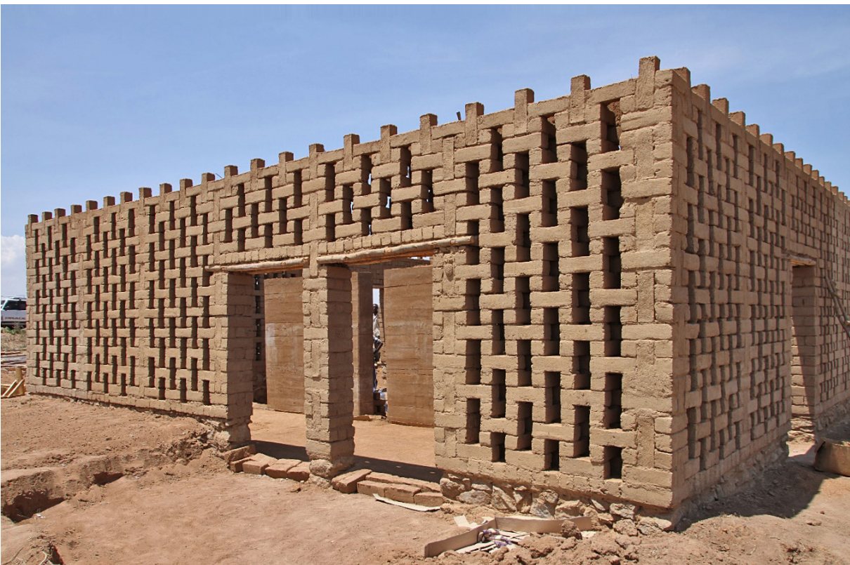
06 Internationale Teilnehmende des Singida Earth House Workshops in Tansania 2016. Überprüfen von Variationen von Mauerwerksschichten vor der endgültigen Errichtung von Wänden (oben) und fertig gebaute Wände (unten).
