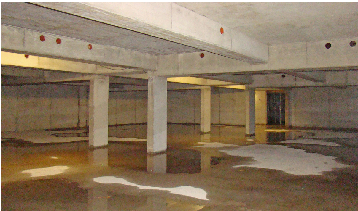
10 Magazin D113 während der Bauphase. Auf dem Boden befindet sich eingedrungenes Regenwasser.
