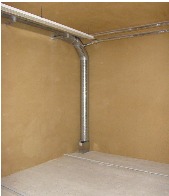
03 Lehmputz im Magazin. Auf dem Boden die Schienen der Rollregal-Anlage. In der Ecke das Lüftungsrohr und rechts oben Vor- u. Rücklauf der Wandflächenheizung
