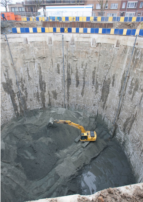
07 Aushub für ein Regenrückhaltebecken durch die Lehmfirma De Meuter in Brüssel. Die geologische Schicht, ein bindiger Lehm, liegt offen da, und ist eine der Aushub-Quellen die BC materials nutzen, um Lehmstoffe herzustellen. (Foto: De Meuter)
